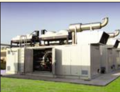
[ Impianto di cogenerazione di Tessari Energia.
