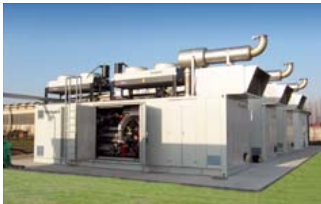
Centrale di cogenerazione da 1 Megawatt con tre motori alimentati a biogas
